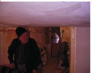
Hauteur sous plafond insuffisante
