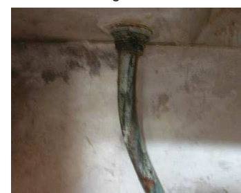
Absence de siphon
