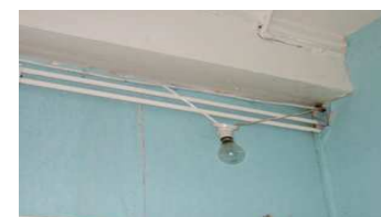
Eclairage insuffisant et dangereux
