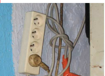
Installation électrique dangereuse
