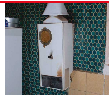
Absence de dispositif d'évacuation des gaz brûlés
