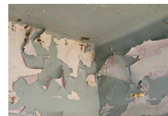
Peinture écaillée contenant du plomb
