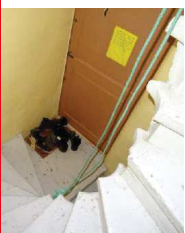
Absence de dispositifs de retenue des personnes
