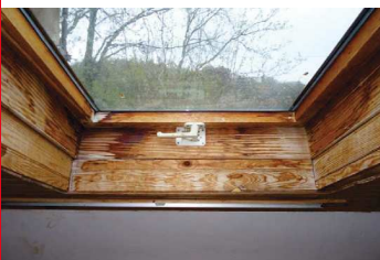
Absence de protection contre les infiltrations d'eau
