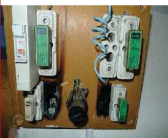
Branchements d'électricité vétustes
